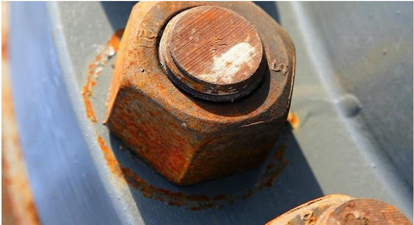
Tipico esempio di corrosione galvanica dovuta al contatto tra ferro e alluminio
